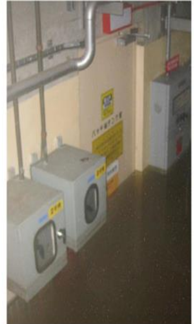
水没した電源室 (福島第一原子力発電所2号機)
